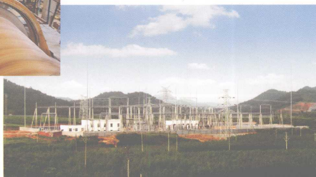
驻县电气化铁路变电站
